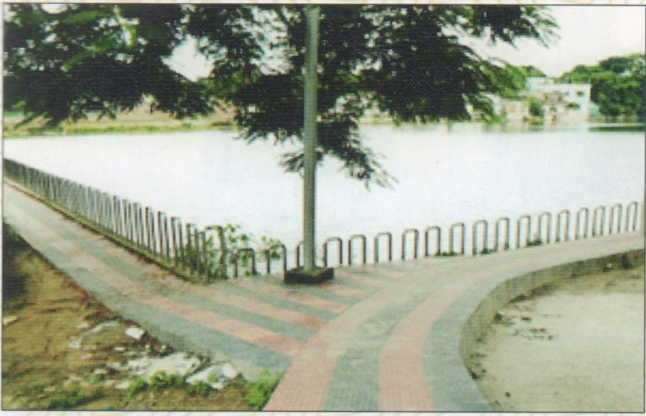
গোমতী পাড়স্থ সংরাইশ কালাচান্দ দিঘী রিটেইনিং ওয়াল ও ফুটপাথ
